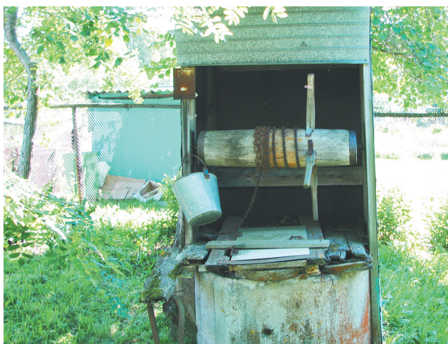
Колодец требует ремонта
